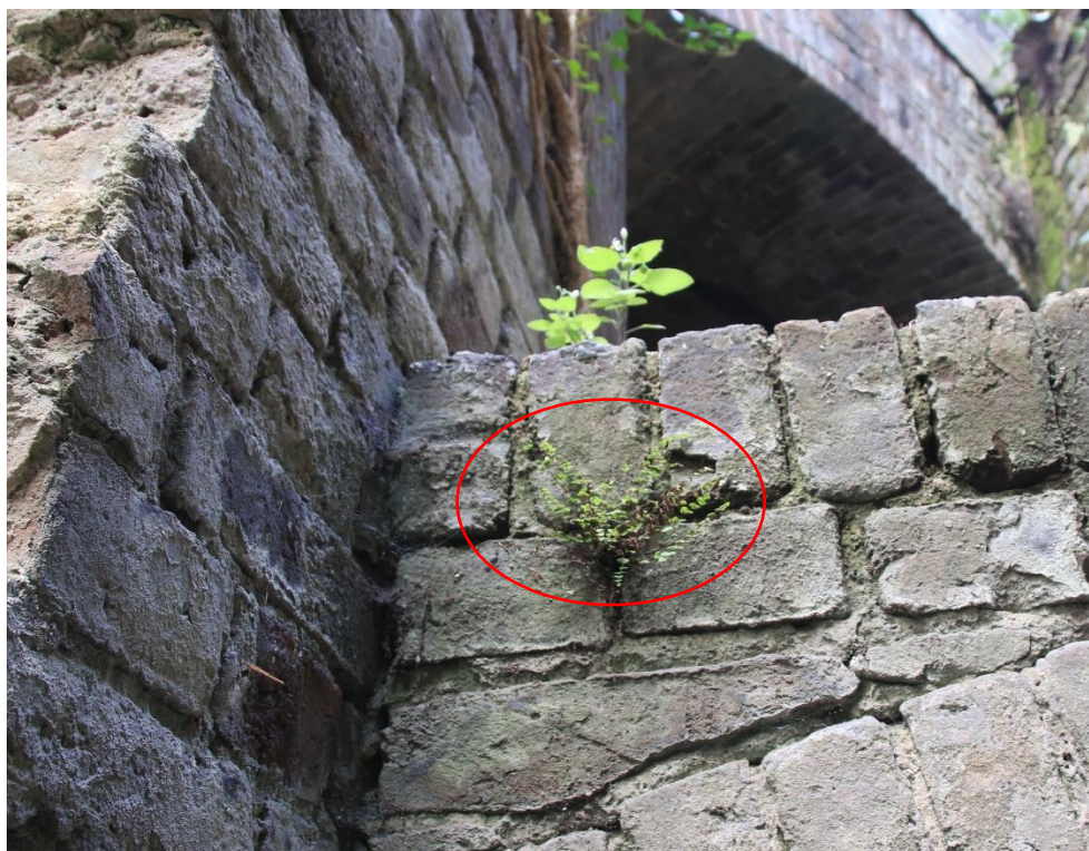
Foto 5: Steenbreekvaren op een oude muur van een oud deel van de fabriekslocatie
